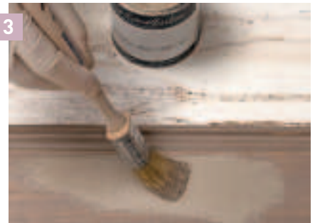
3 Frühestens 24 Stunden nach dem ersten Farbanstrich und nachdem ein kurzer Zwischenschliff erfolgt ist, wird der zweite Anstrich wiederum dünn aufgetragen und gut ausgestrichen.
