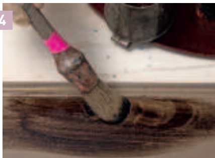
4 Für die Holzimitation wird zunächst eine farblose Öllasur aufgetragen, die auf der Oberfläche mit Pigment von der Palette gleichmäßig eingefärbt und mit dem Modler auf der Fläche verteilt wird.
